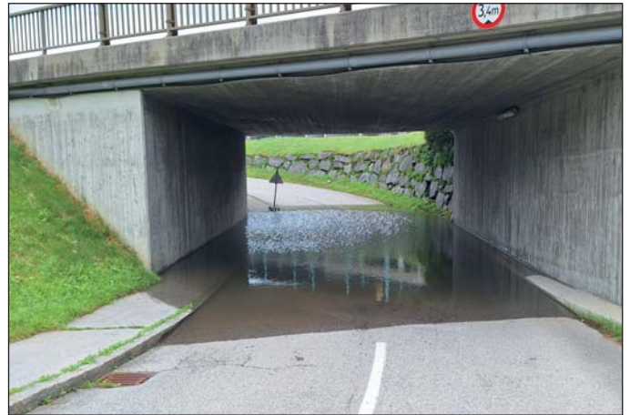
Überflutete Unterführung im Bereich Autohaus Altenweisl
